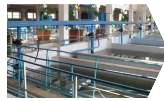
МУП «УПРАВЛЕНИЕ «ВОДОКАНАЛ»
